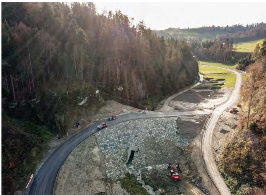
Abb. 2: Sicht auf die Talseite des Hochwasserschutzdamms und den Einstaubereich im oberen Teil des Fotos.
